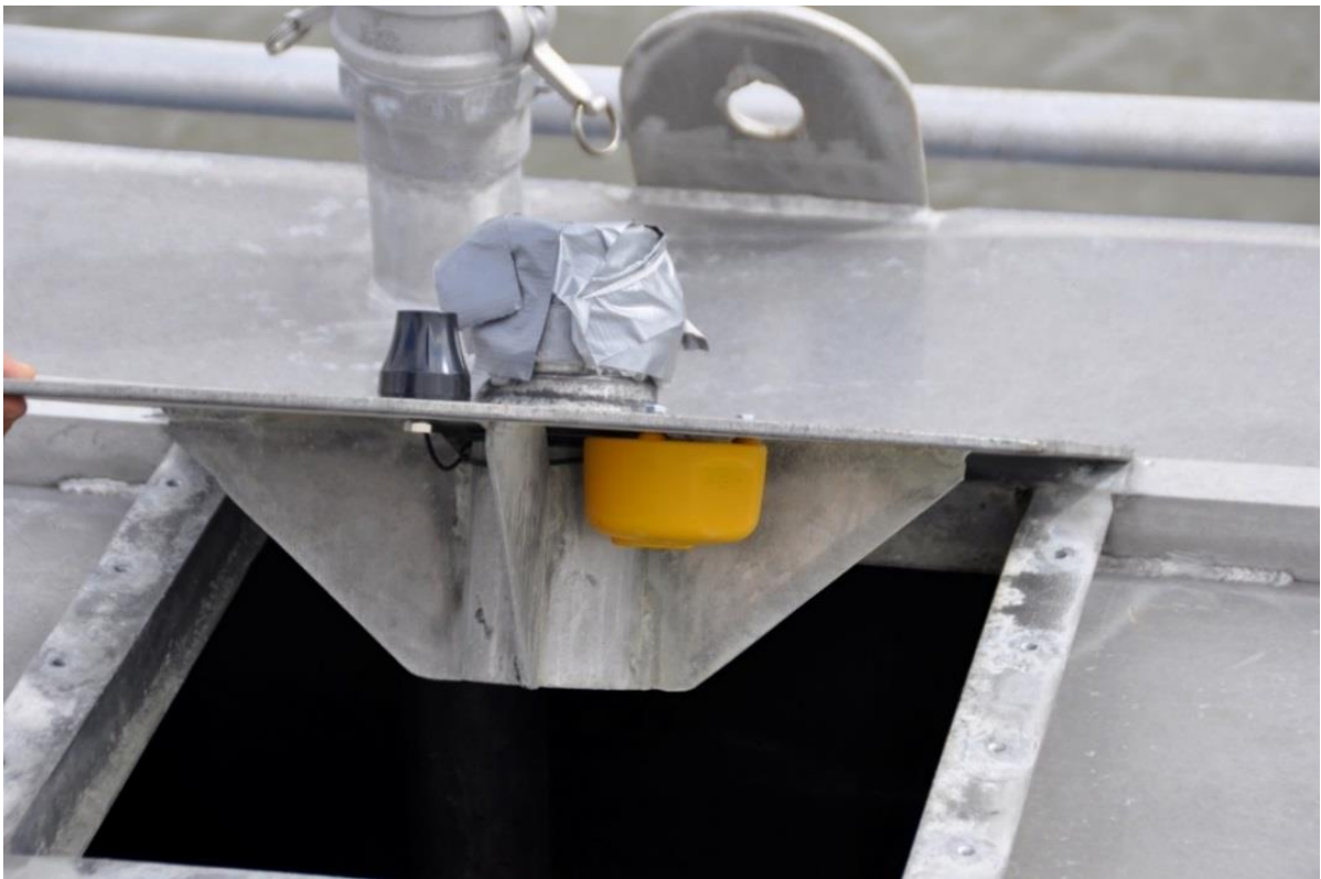
Kuva 2. Enevo Oy:n OneCollect sensori Helsingholmin septiaseman manusluukussa
